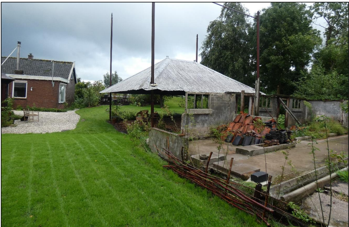
Figuur 4 De bebouwing bestaat uit een overkapping opgetrokken uit vier metalen palen en een dak bestaande uit hout en golfplaten en een voormalig bijgebouw opgetrokken uit stenen muren met houten balken, dit gebouw is volledig open door het ontbreken van een dak.
