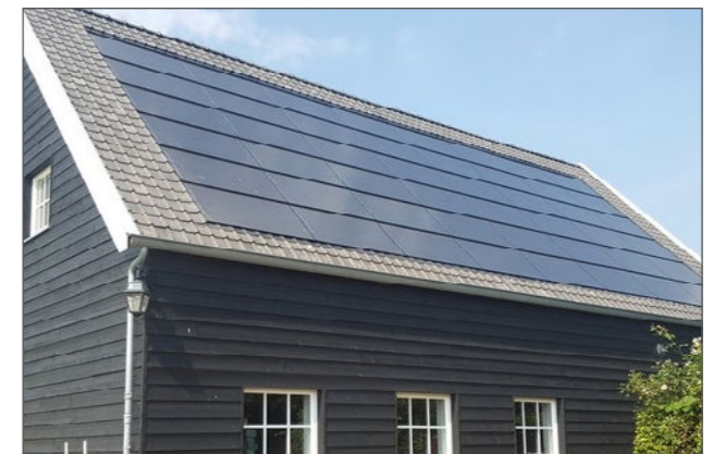
Zonnepanelen architectonisch onderdeel van het dakvlak
