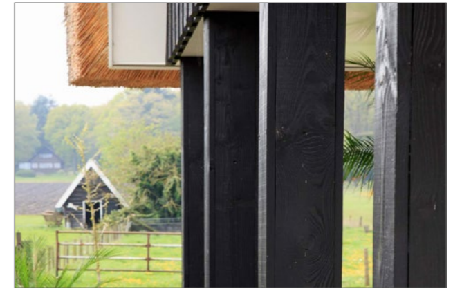
hout in gevelwerk
