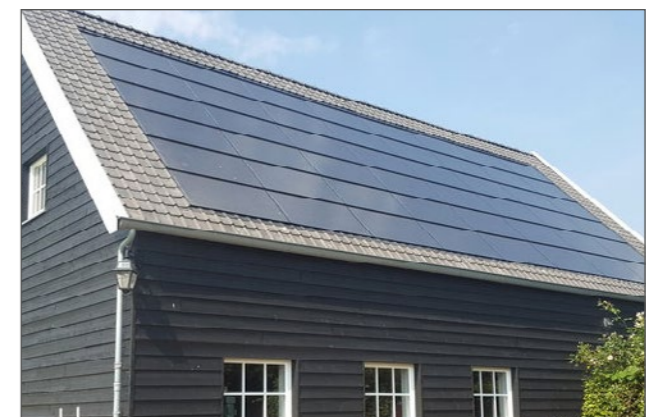
Zonnepanelen architectonisch onderdeel van het dakvlak
