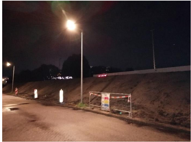
Figuur 3. Het gebouw. Op de locatie waar een sloot aanwezig was, is een talud gemaakt. Het gebouw is intact.
