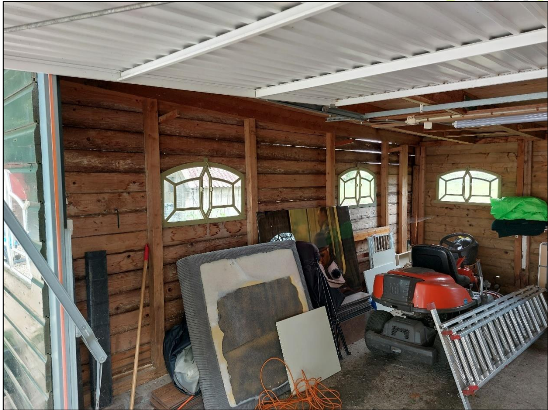
Binnenzijde van bijgebouw 1 met duidelijke kieren tussen de houten planken. Foto: G.S. Posthuma | Ecoresult B.V.
