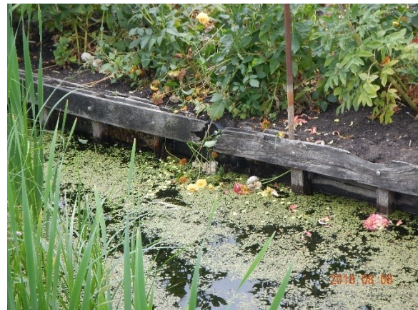
Oeverbescherming met schade
