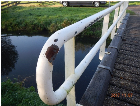
Brug met schade
