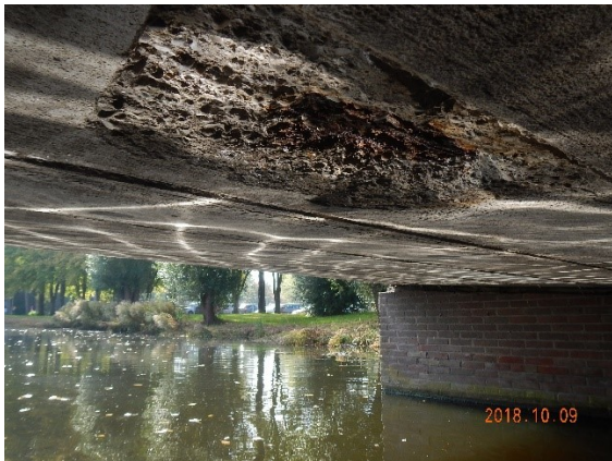
Brug met beton schade,
