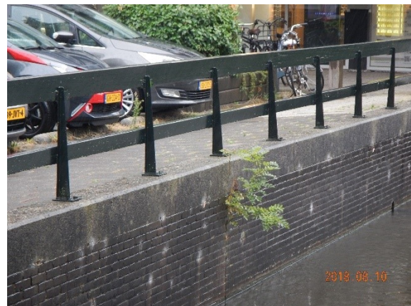
Kademuur met scheurvorming
