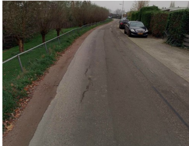
Asfalt weg met scheurvorming, Ronde Hoep Oost
