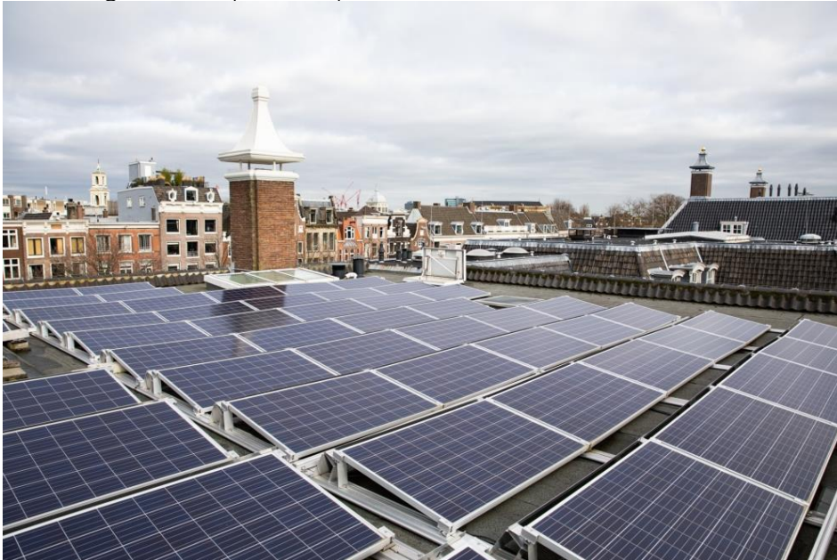
Afbeelding 6.1 Zonnepanelen op Amsterdams dak
